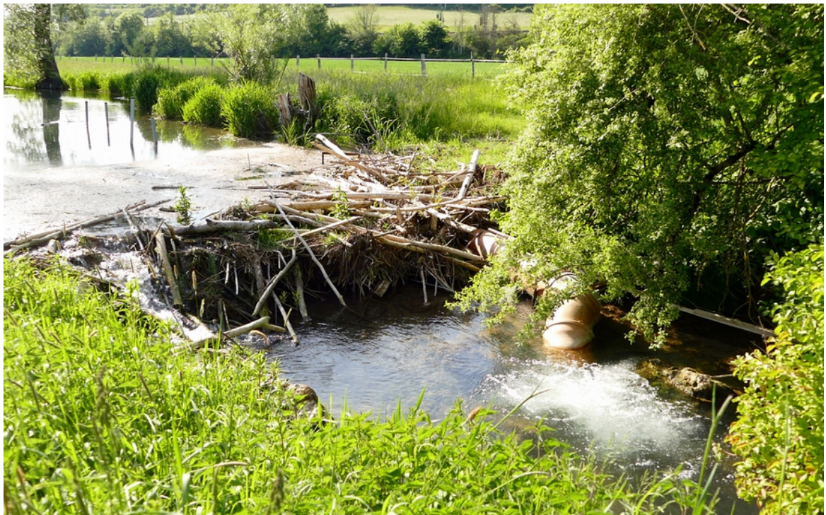
F005 Biberdamm an der "Lone" (Biber-Management – hier: Sicherstellung der Wasserableitung) im Alb-Donau-Kreis.
