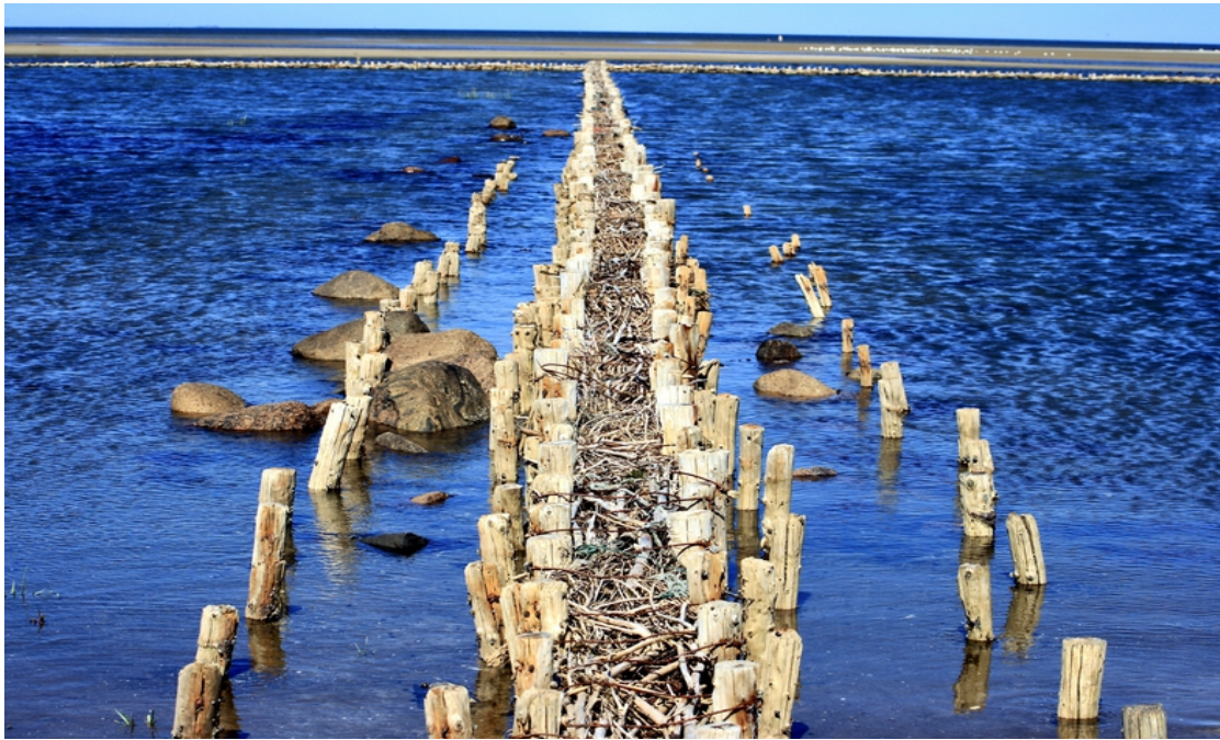
F035 „Lahnungen“ (zwischen Pfahlreihen gepackte Buschdämme) als Uferschutzanlage...
